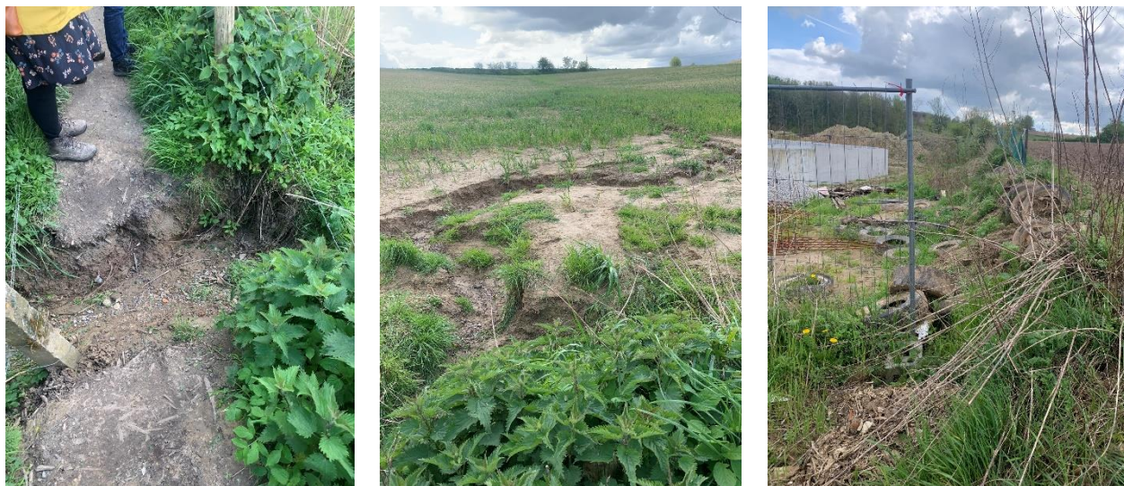
Figuur 50: Doorbroken erosiedam landbouwveld Reybroekstraat (links), geulen in landbouwveld Reybroekstraat (midden), sporen recente afstroming Dorenstraat (rechts).
