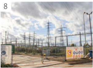
zicht op het hoogspanningsstation
