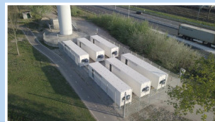
Batterij-opslag van windenergie: © https://www.klimaatplein.com/grootste-batterij-bij-windpark-in-nederland-in-gebruik-genomen
